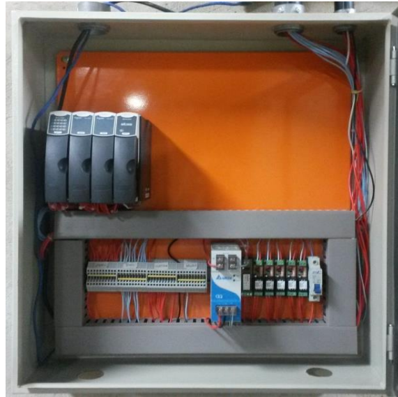
Figura 4.8 – Painel elétrico com o CLP
